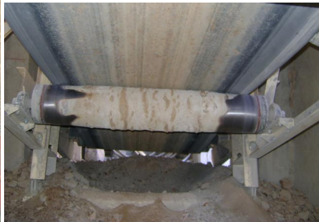
Encrassement et blocage des rouleaux
